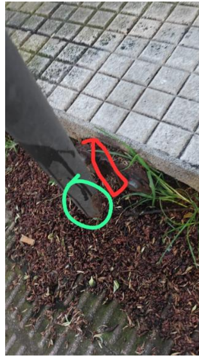
FAROLA CORROIDA EN EL BARRIO EL CARMEN
